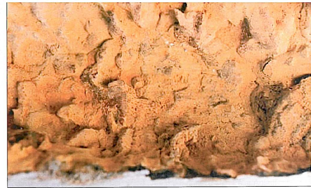
Abb. 2: Korrosion an einem Rohr. (Quelle: Grünbeck Wasseraufbereitung GmbH)
